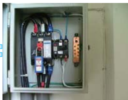
電源上鎖及標示
